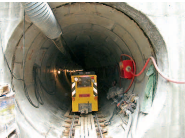
Eine Tunnellokomotive von Rensmann aus Dortmund im Einsatz beim U-Bahnbau in Moskau.
